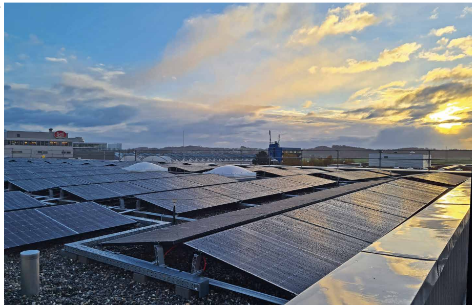
Bild 8: Eine Fotovoltaikanlage sorgt für umweltfreundlichen Strom.
