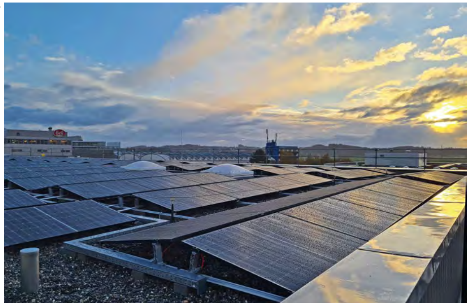
Bild 8: Eine Fotovoltaikanlage sorgt für umweltfreundlichen Strom.
