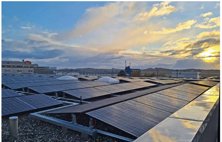
Photographie 8 : Des panneaux photovoltaïques 8 produisent de l'électricité écologique.
